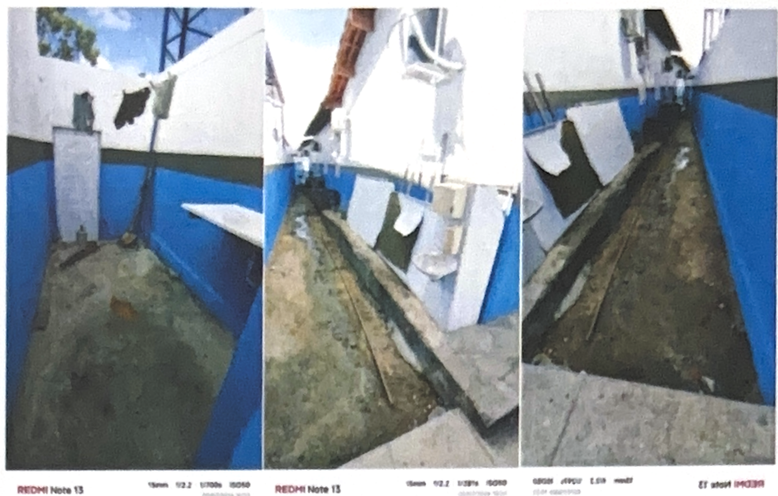
PIA E ESGOTO A CÉU ABERTO
